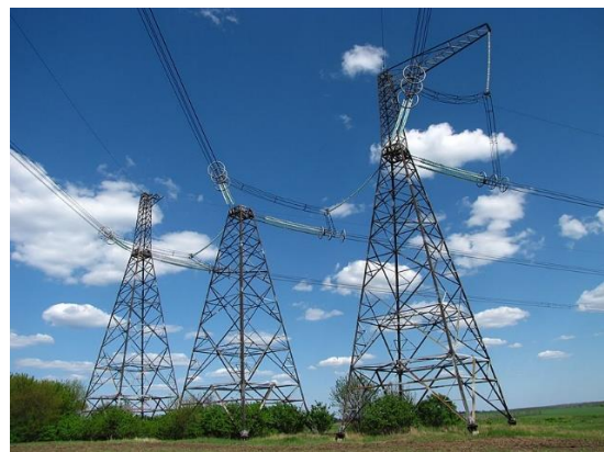
Мал.26. Трьохстійкова анкерно-кутова опора повітряної ЛЕП 750 кВ
