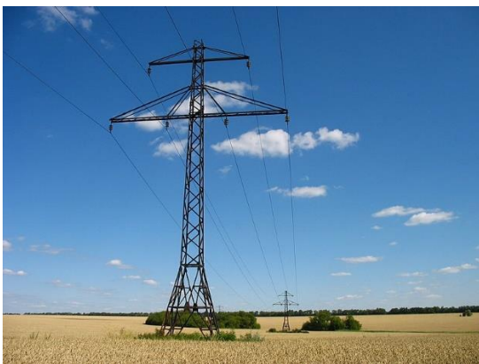
Мал. 24. Проміжна металева опора ЛЕП 35кВ
